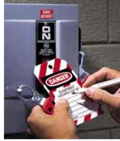
FIGURA 3 - Desactive y marque el sistema de aire acondicionado en el panel eléctrico (utilice el procedimiento de bloqueo/etiquetado, LOTO e indique la fecha, la hora y el nombre de la persona que coloca la etiqueta)
